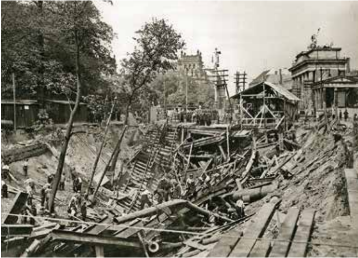
Der Einsturz der Baugrube des Nord-Süd-Tunnels am 20. August 1935 im Bereich kurz vor dem Brandenburger Tor kostete 19 Arbeiter das Leben.
