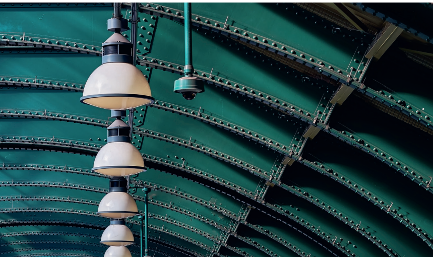
Lampen an dem denkmalgeschützten Hochbahn-Viadukt an der Schönhauser Allee.
